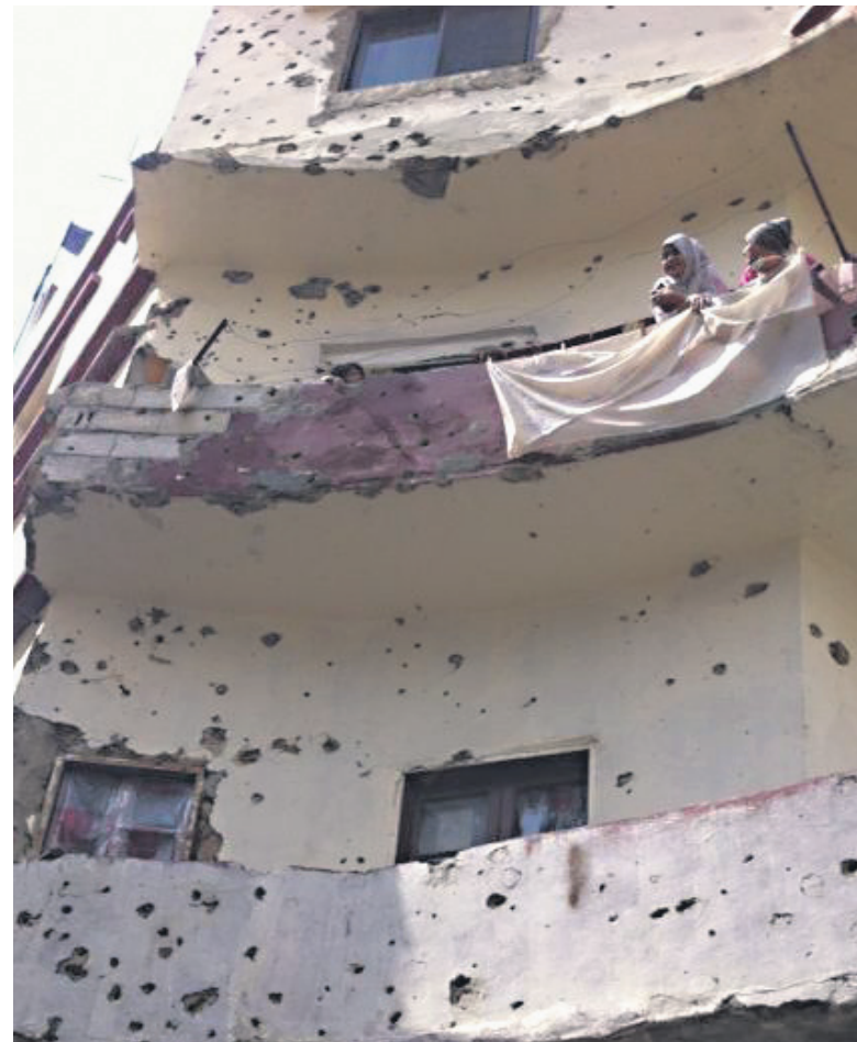
Une façade criblée de balles, dans le quartier de Baal Darawiche, à quelques mètres à peine de Jabal Mohsen, quartier historiquement ennemi.
